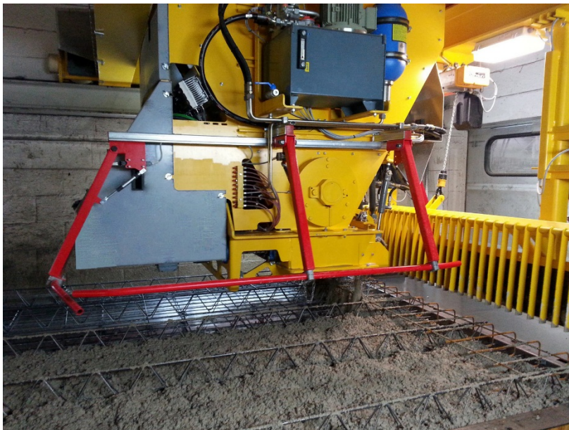
Figura 4 O recém-instalado distribuidor automático de concreto aumenta significativamente a qualidade das lajes, além de reduzir a descarga de concreto.
