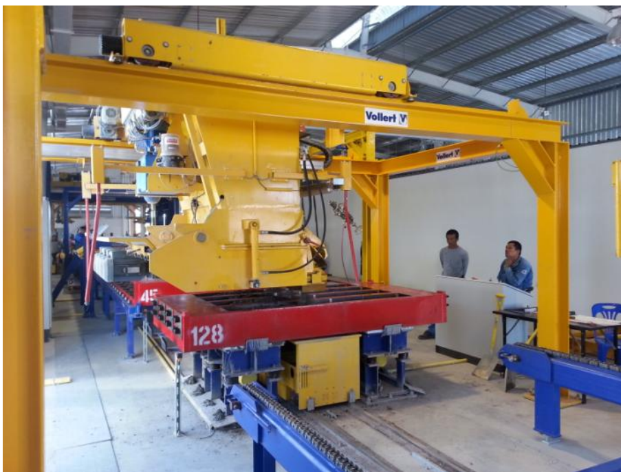
Fig. 6: Бетонная смесь выгружается в закрепленную механическим способом форму при помощи электроприводных шнеков
