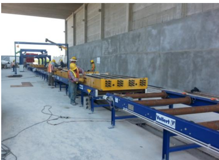
Fig. 3: O molde pré-montado é transportado para a câmara de concretagem à prova de ruído através de uma esteira de rolos
