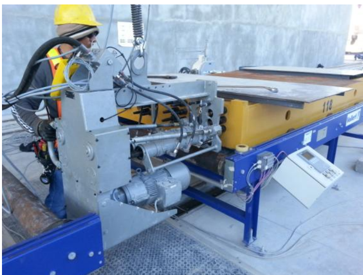
Fig. 2: De seguida, os cabos são protendidos mediante as cavilhas de protensão, sendo o torque de aperto de cada cabo tensor constantemente monitorado e protocolado
