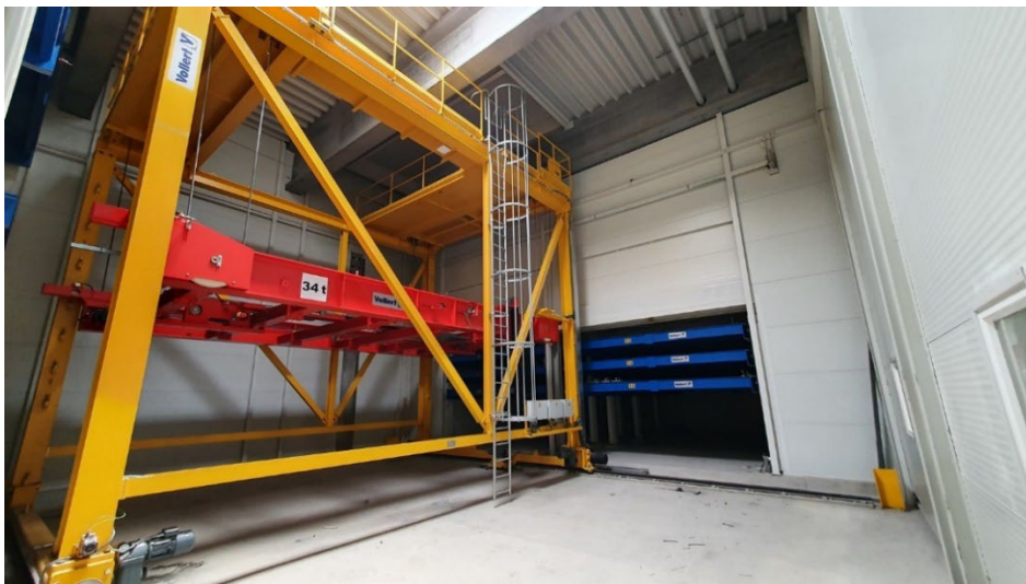
Фото 7: Полностью изолированная и обогреваемая камера сушки VARIO CURE является центральным элементом новой линии по производству стен.
