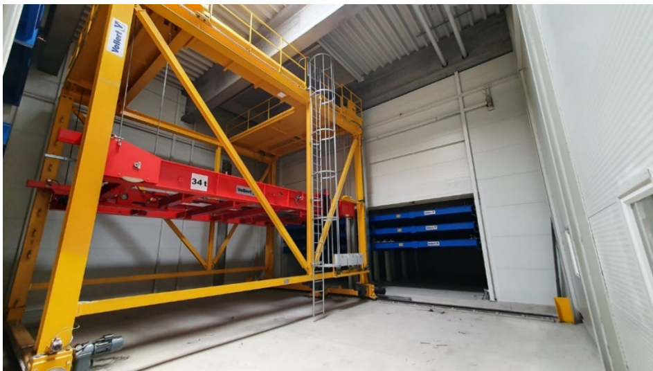
Photo 7 : La chambre de durcissement VARIO CURE, entièrement isolée et chauffée, constitue le cœur central de la nouvelle ligne de production de murs.
