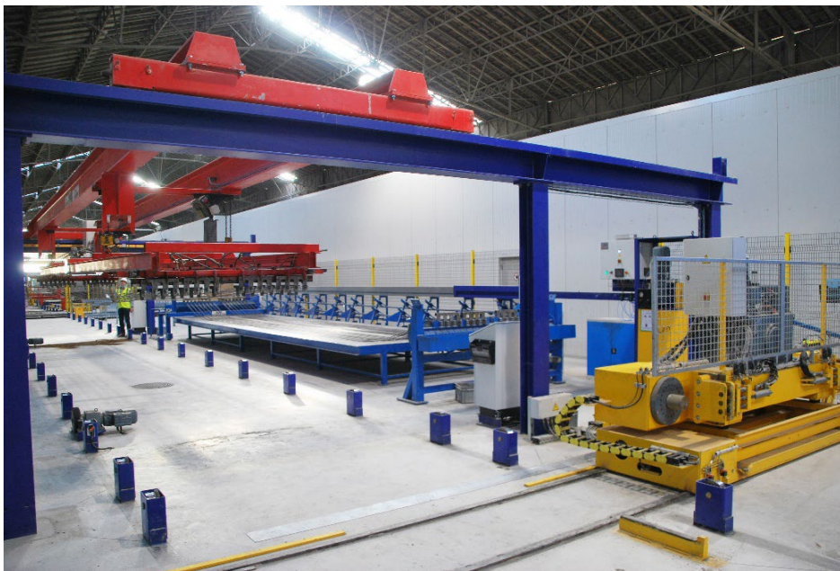
Figura 2 Após os feixes de fios terem sido inseridos nas formas, o macaco de protensão pré-tensiona hidráulicamente os fios de aço suspensos.
