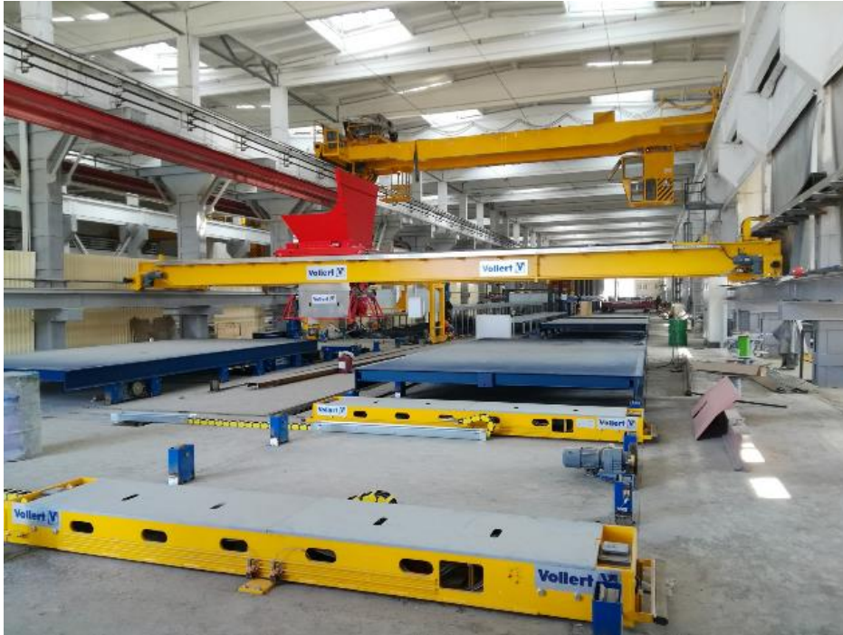
Figura 3 A separação das áreas de concretagem garante uma sequência óptima, e um ciclo elevado.
