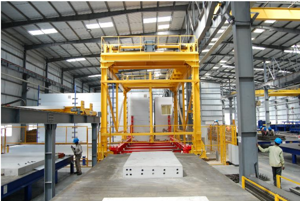
Fig. 4: En la nueva fábrica de Sobha se producen hasta 400 000 m 2 anuales de elementos prefabricados de hormigón para el complejo residencial Dream Acres en Bangalore.
