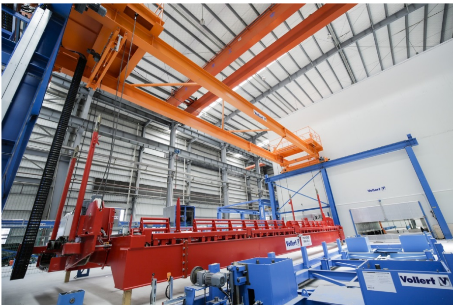
Fig. 6: Dispositif de retournement de palettes ultramoderne VARIO TURN guide au plafond, destiné à la production de prémurs
