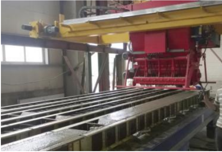
Fig. 5: Grâce à une structure à portique, il est possible de couler une surface pouvant aller jusqu'à 3,20 m
