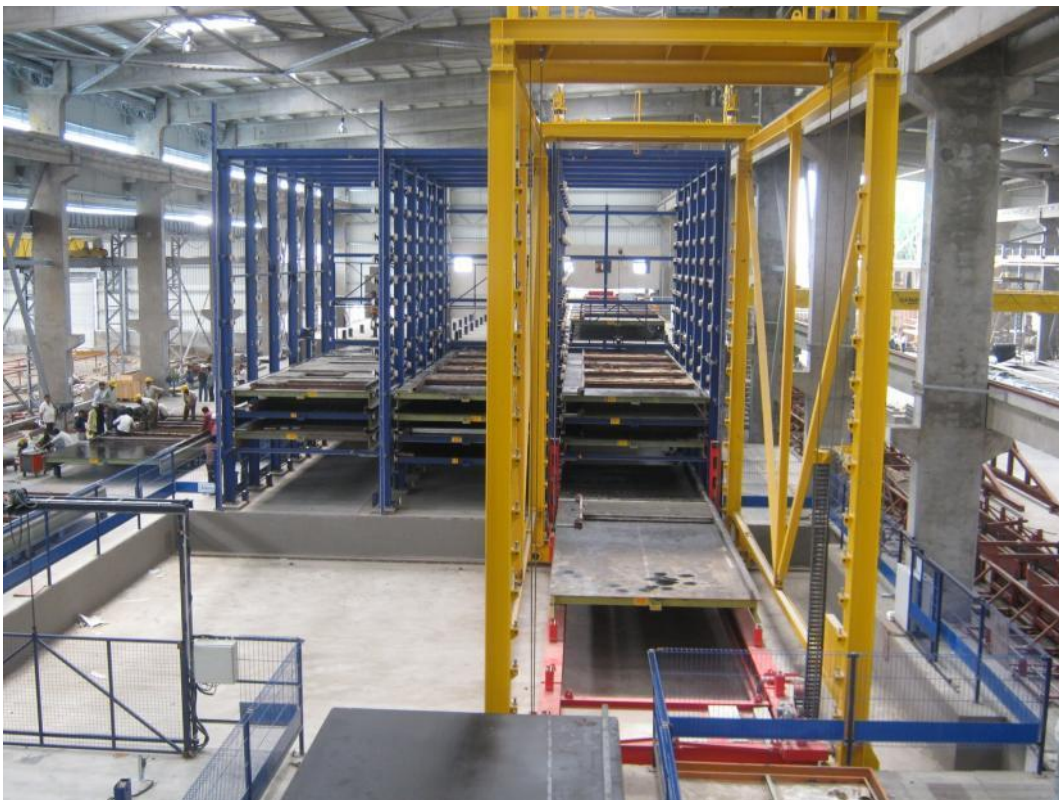
Fig. 12: Armazenamento automático e recuperação para transferir as pallets até a câmara de cura
