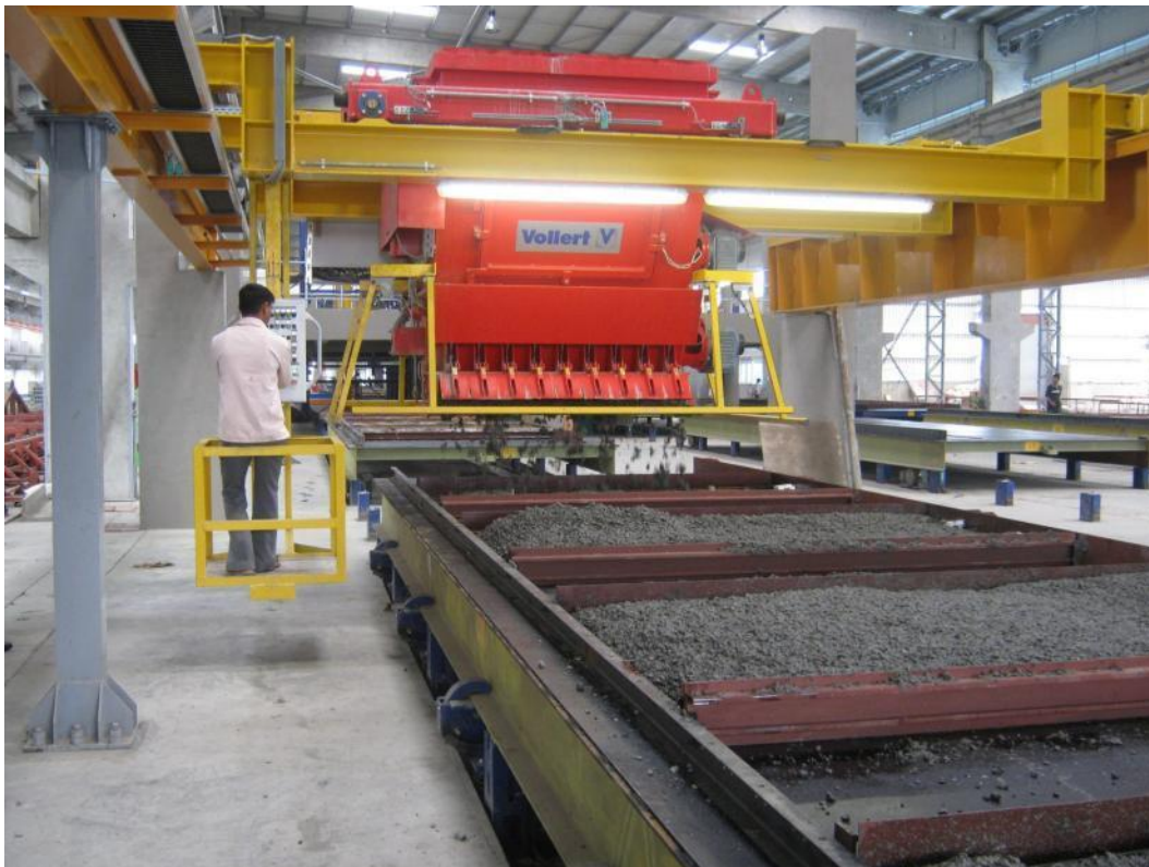
Fig. 7: Difusor de concreto com plataforma móvel de operação
